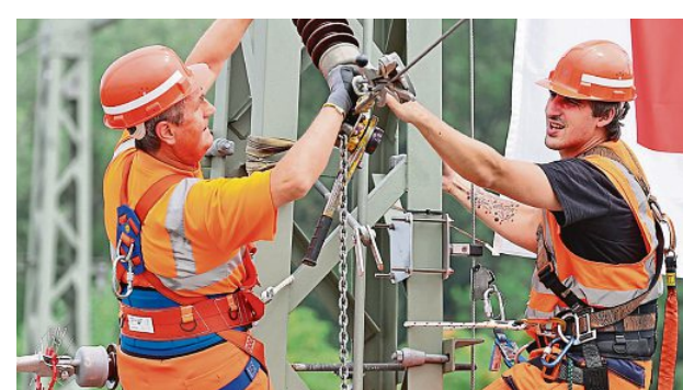
Draußen unterwegs: Die Fachkräfte installieren, warten und reparieren Oberleitungen, aber auch Photovoltaik- und Windkraftanlagen.
